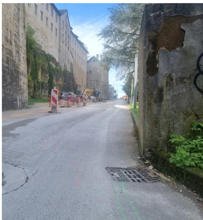
À l'amorce de la rue du Château, une partie du transformateur électrique (au 1 er plan à droite de l'image) sera détruite, de façon à améliorer la visibilité.
