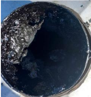
Un conduit de cheminée envahi par le bistre.
